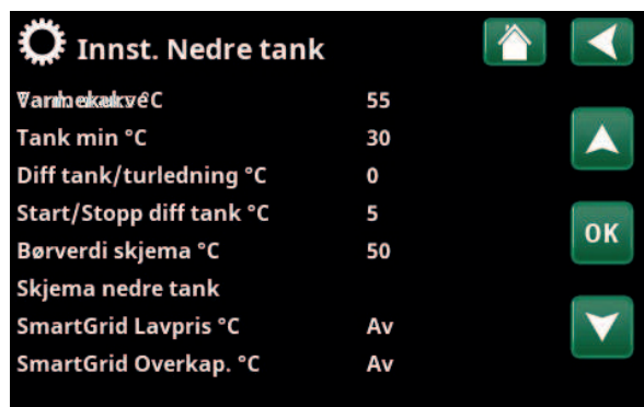
Meny «Avansert/Innstillinger/Nedre tank».
