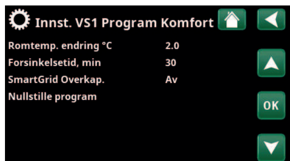
Meny «Avansert/Innstillinger/Varmesystem/ Varmesystem 1/Program/ Comfort».
